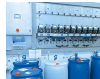
weigomatic® Dosieranlage und Dosierraum für Prozesschemikalien
