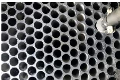
Abbildung 3: Sicht von oben auf die Röhren des Eindampfers nach der Reinigung
