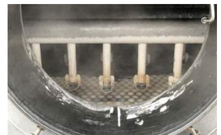
Abbildung 2: Einblick in den Eindampfer vor der Reinigung. Oxalat-Beläge auf den Spritzdüsen, Röhren und in den Fallröhren.
