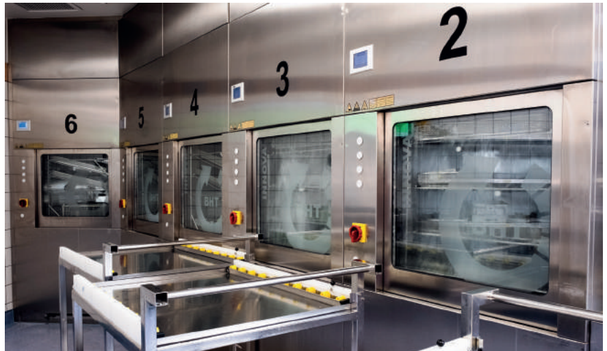
Im Eduardus-Krankenhaus wurde neodisher® MediClean advanced – zunächst als Testprodukt – unter Realbedingungen in der AEMP auf Herz und Nieren getestet.
