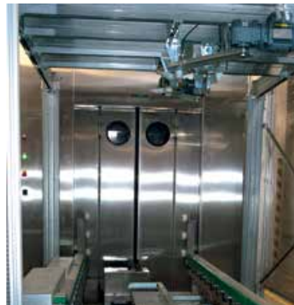
In den mannshohen Waschkammern werden die Container gespült
